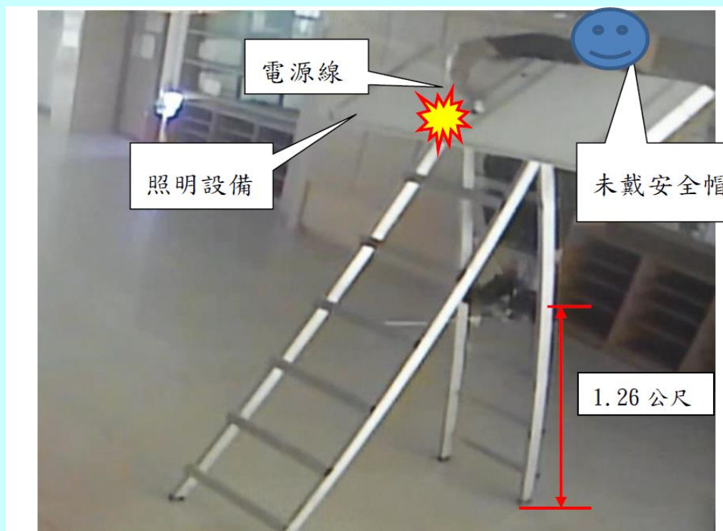
照片 蕭員拔除照明設備電源時發生感電墜落。(監視器截錄畫面)
